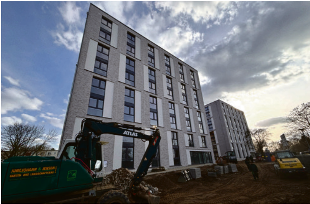
► Blick auf die beiden Kopfbauten an der Max-Planck-Straße, die ab April zusammen 152 neue Wohnheimplätze für Studierende bieten werden.
